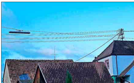
Die Überspannungsleuchten und die Dachständer für die Stromversorgung sollen in den nächsten drei Jahren im Dorfbild verschwinden. Foto: ma
