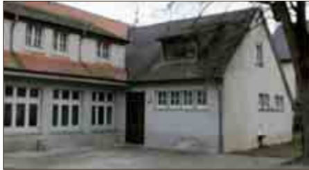
Das Gemeindehaus St. Stephan muss dringend saniert werden.
